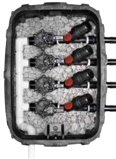
Quatro kits de zona de controlo numa caixa de válvulas padrão
