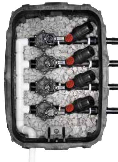
Cuatro kits de control de zona en una caja de válvulas estándar
