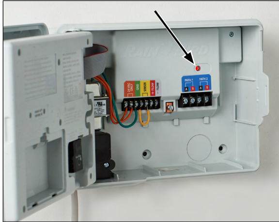
Controlador con puerta y panel frontal abierto
